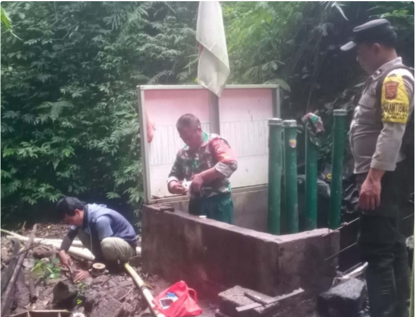
Bantu atasi kesulitan air, Babinsa rutin rawat pompa hydrant di Gobleg
